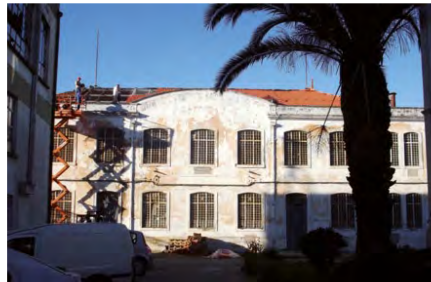
O EDIFÍCIO QUE ACOLOHA O ESCRITÓRIO PRINCIPAL DA MDF, FOI CEDIDO À JUNTA DE FREGUESIA DO TRAMAGAL PELO GRUPO DIORAMA E ESTÁ ATUALMENTE EM OBRAS DE RECUPERAÇÃO.
